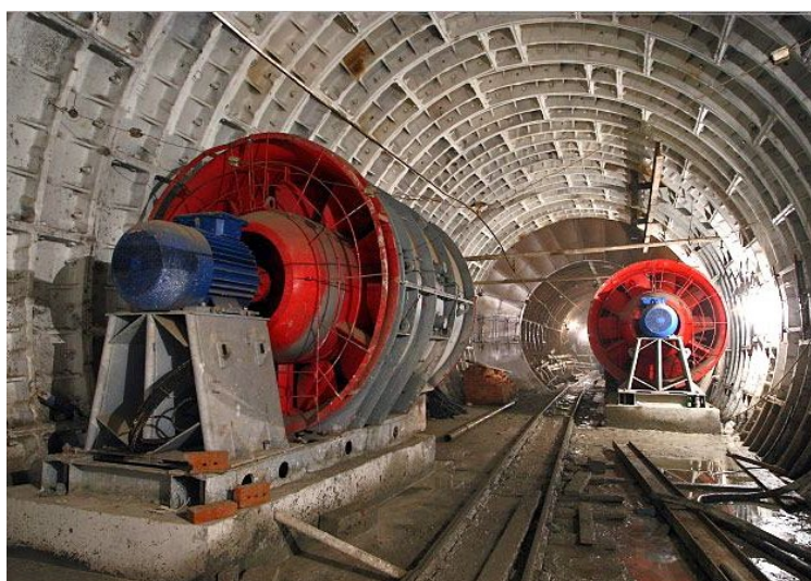
Рис. 4.1. Вентиляторы местного проветривания
